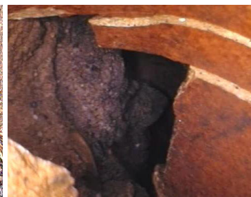
Fehlendes Rohrstück, Hohlraum sichtbar
