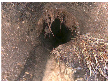
Wurzeleinwuchs an undichter Rohrverbindung
